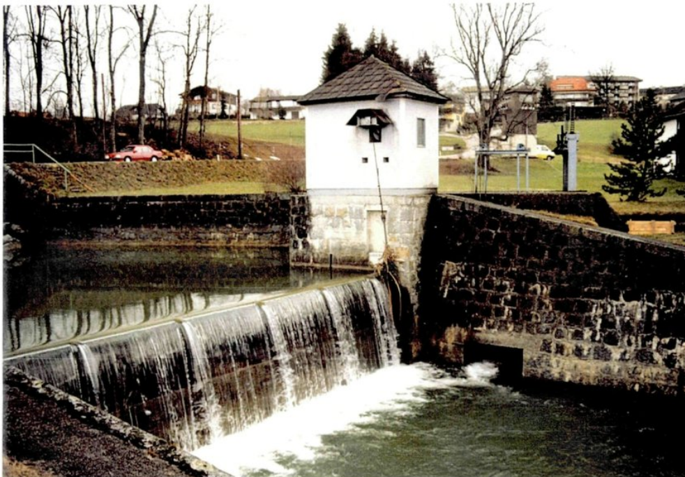
Abb. 28: Blick auf die Wehranlage der Moosmühle mit der Ausleitung des Mühlbaches und dem Überschußgerinne
